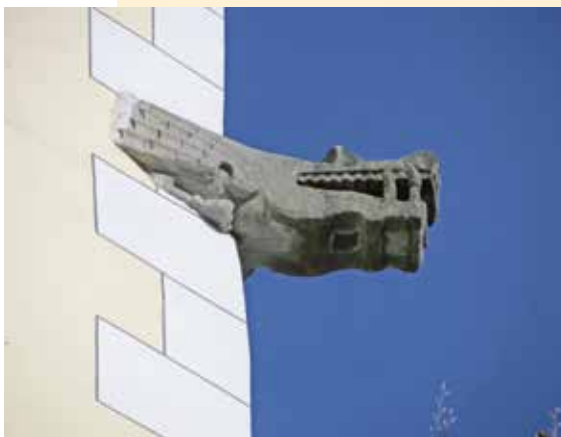
Wasserspeier aus Sandstein, Pfarrkirche St. Peter und Paul, Mels (Abb. 5).
